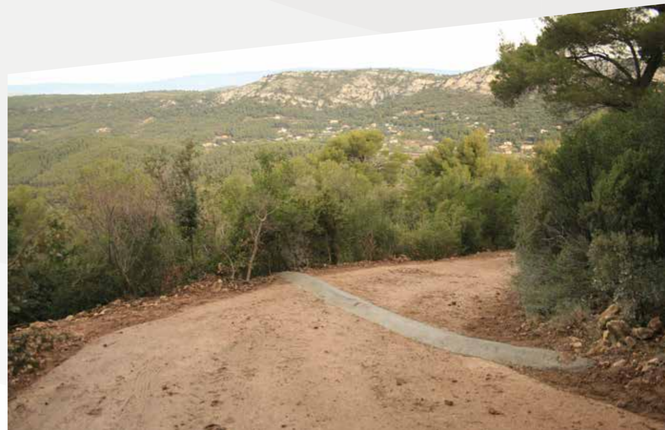
Réhabilitation de la piste des Venturiers sur Sainte-Victoire (source : photo de chantier / ONF)
