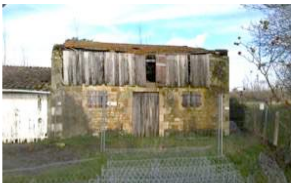
Avant : annexe de la maison éclusière dégradée.
